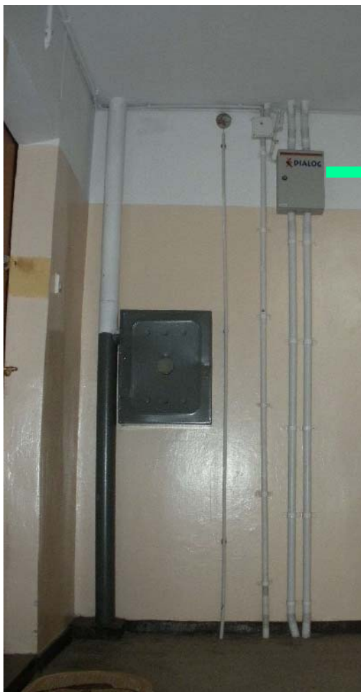
Pion w klatce schodowej
