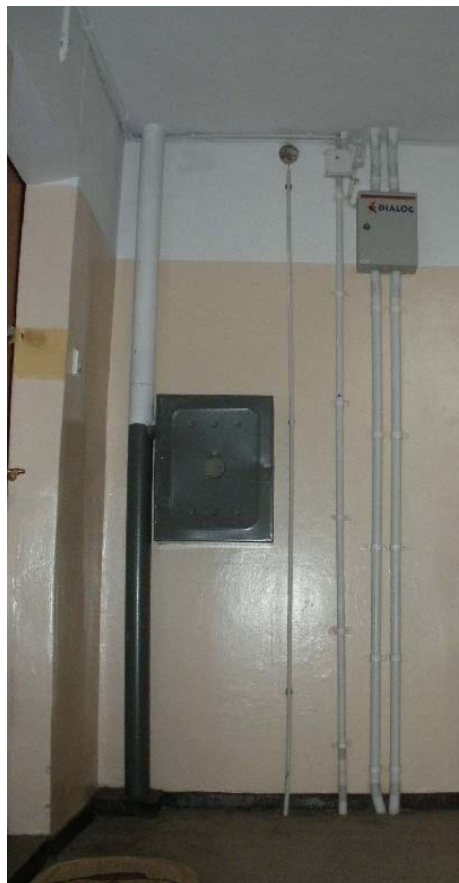
Pion w klatce schodowej
